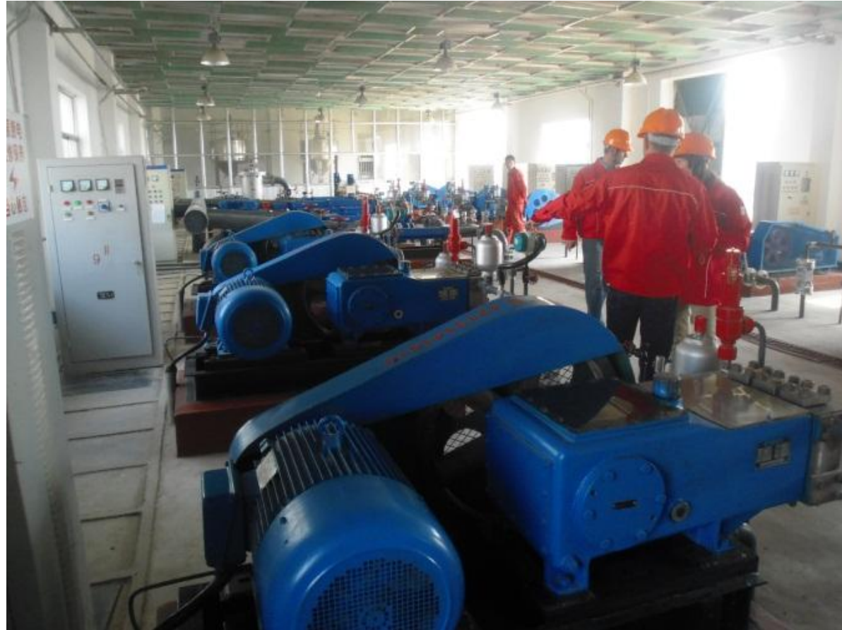
Polymer water injection station Станция закачки раствора полимера
